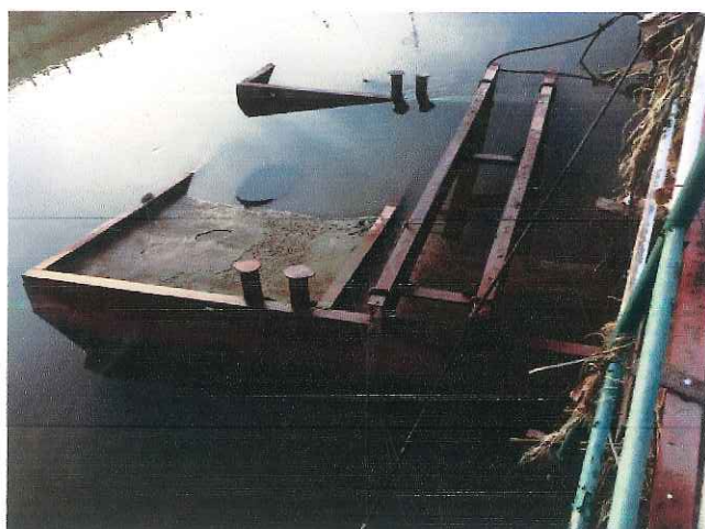
3. Đoạn đầu cầu Hải Phòng (một phần bị chìm)
