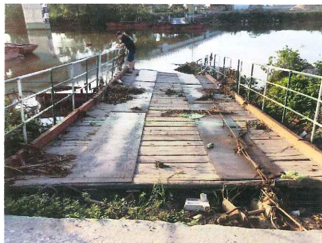
2. Đoạn đầu cầu Hải Phòng (một phần bị chìm)
