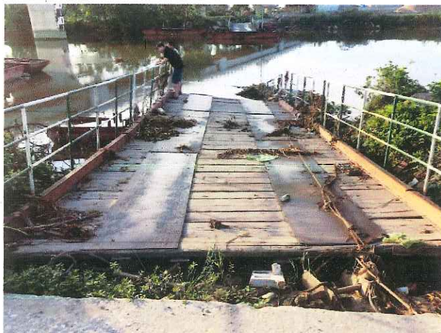
1. Đoạn đầu cầu Hải Phòng (một phần bị chìm)
