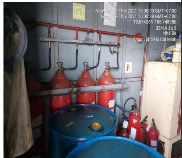
Trạm CO2 chữa cháy
